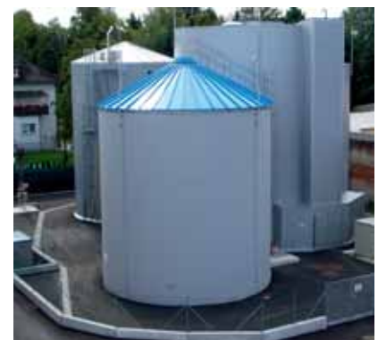
Biogas Plant, Landfrisch Molkerei, OO Photo: Landfrisch Molkerei
